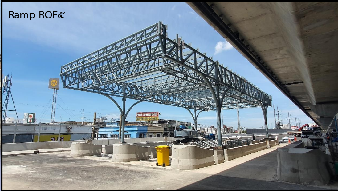
ภาพถ่ายงาน Canopy Structure – ด้านพุทธบูชา (Ramp 5)
