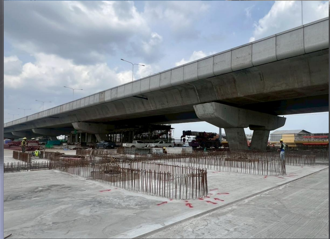
ภาพถ่ายงาน Toll Island and Concrete Barrier – ด้านบางมด (Ramp 4)
