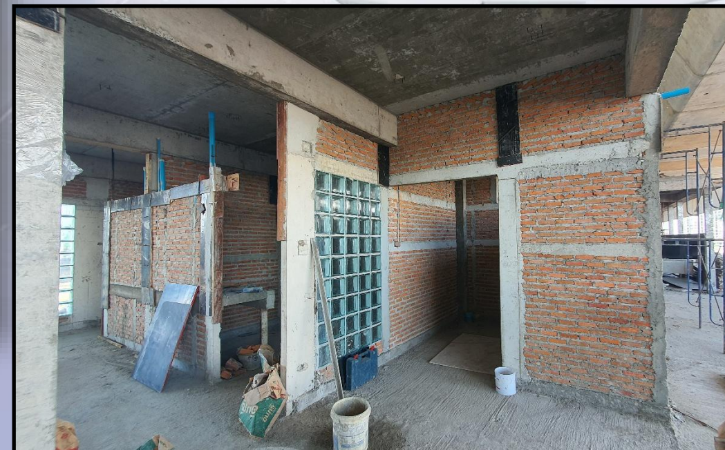
ภาพถ่ายงานก่อสร้างอาคารบริเวณด้านบางมด (Ramp 4)
