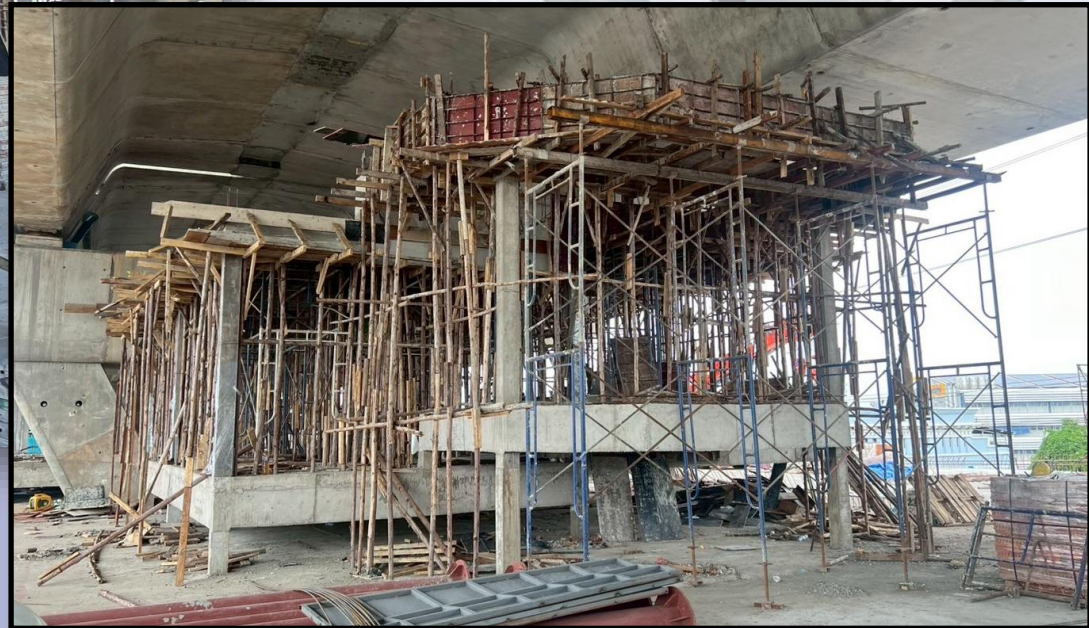
ภาพถ่ายงานก่อสร้างอาคารบริเวณด้านบางมด (Ramp 4)
